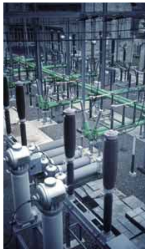
Neben Hochspannungsleitungen erzeugen auch Unterwerke innerhalb der Umzäunung relativ starke Magnetfelder.
